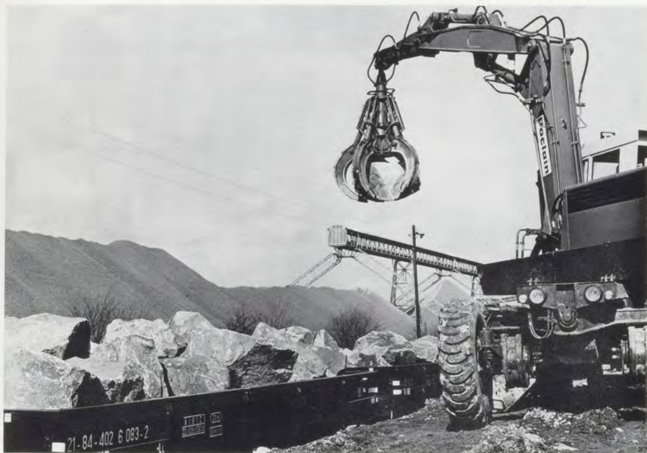
Afb. 4. Het laden van breuksteen in een Belgische groeve. De wagens zijn verbouwde kolenwagens. Elke werkdag rijdt een stentrein naar Europoort, waar een loseplacement is gebouwd met 11 km spoor en 21 wissels. Als de nieuwe havenpier in Hoek van Holland in 1971 gereed is, hebben daar 1700 treinen voor gereden.
